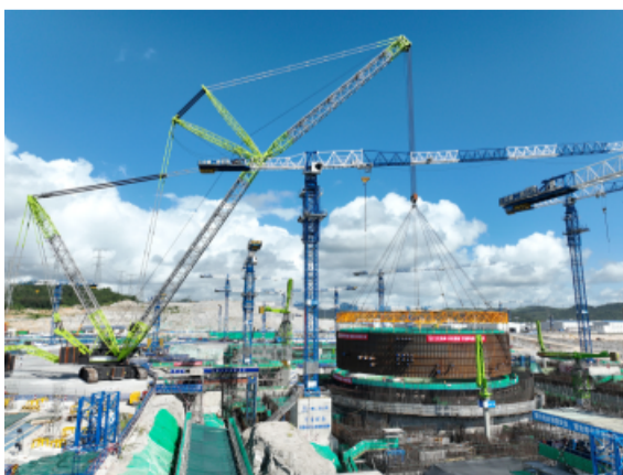
漳州核电3号机组反应堆厂房安全壳钢衬里模块二吊装成功
